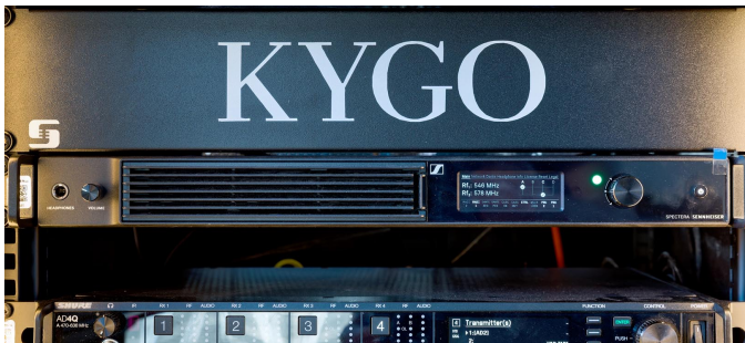
La Base Station Spectera installée au poste de contrôle fonctionnait avec deux canaux RF à large bande dont les fréquences centrales étaient de 546 et 578 MHz.
